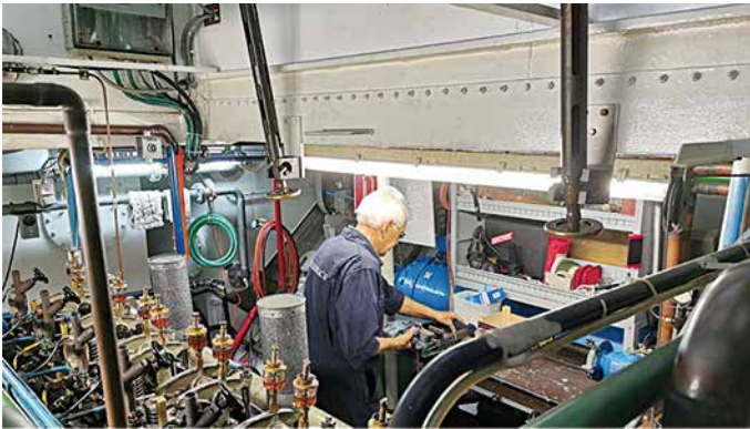
Neben den schiffsbetriebstechnischen Aggregaten befindet sich auch eine Werkstatt im Maschinenraum. © Kaack, Ulf
